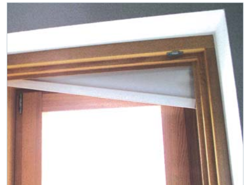
Bei diesem Fenster blieb das Rollo schräg in den seitlichen Führungsschienen hängen.
