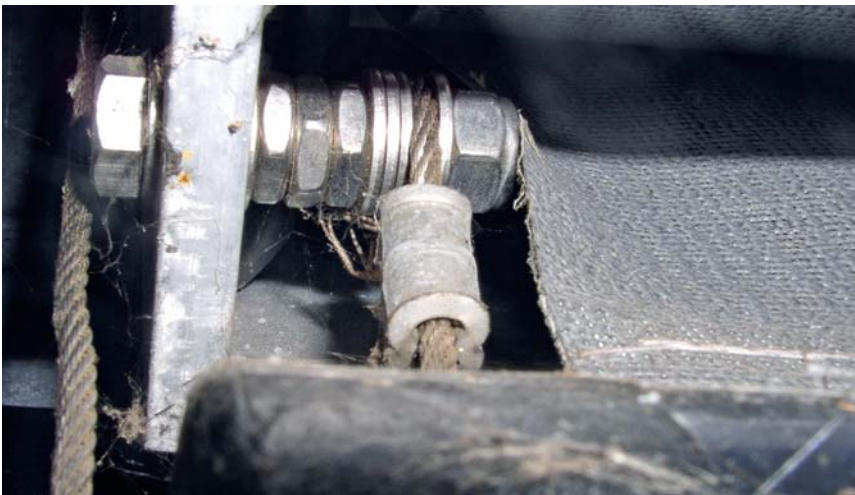
Fachgerechte Montage sieht anders aus. Dieses Foto zeigt, wie der Soltis-Behang und die laufende Anlage an der Schraube hängen bleiben.
