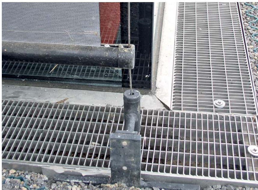
Auch im unteren Bereich hat die zuständige Firma die Spanntöpfe nicht lotgerecht und damit fachgerecht montiert.
